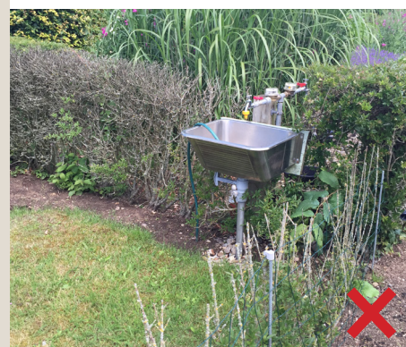
Eksempel på vask med ulovlig håndtering af spildevand, hvor spildevand siver direkte ned i jorden. Spildevand fra vasken skal opsamles i beholder, der tømmes i fælles tømmefaciliteter.
